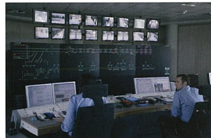
Fig. 3 - Posto di comando e controllo (PCC) della metropolitana ad automazione integrale VAL.
