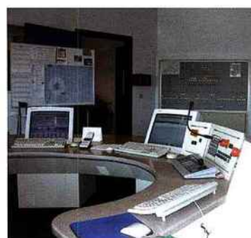
Salle de supervision
