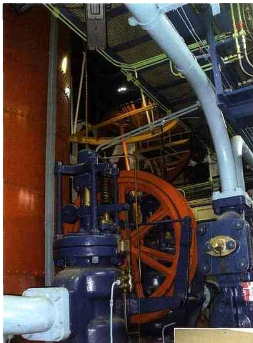
Salle des machines.
