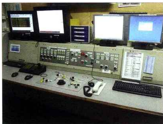
Salle de maintenance.
